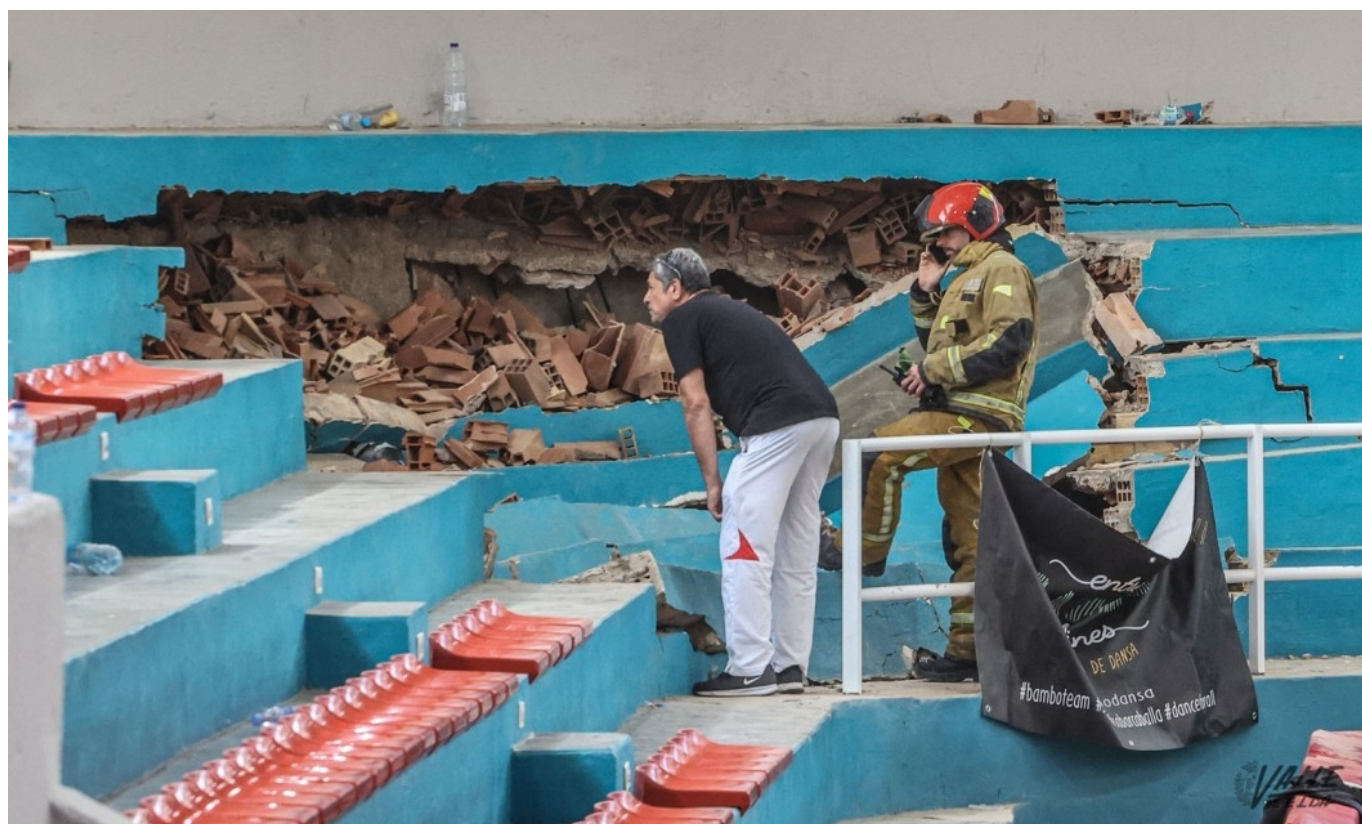
Estas instalaciones se cerraron al público en mayo del 2022 tras el derrumbe de una parte de la grada | Archivo Valle de Elda J.C.
