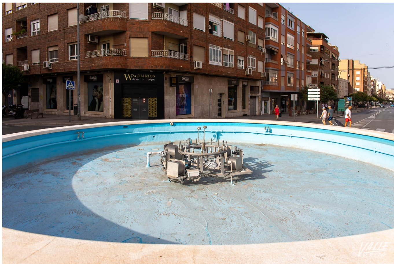
La fuente de la avenida de Madrid se ha estropeado | Marta Maestre.
