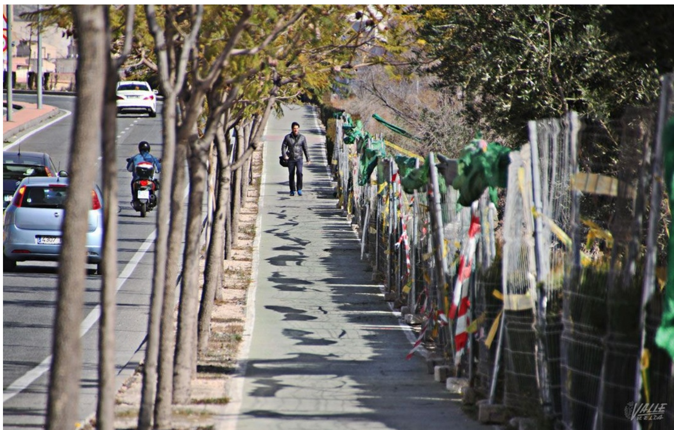
En las obras se contempla la instalación de 2.000 m 2 de viales para conectar con el CEE | Jesús Cruces.
