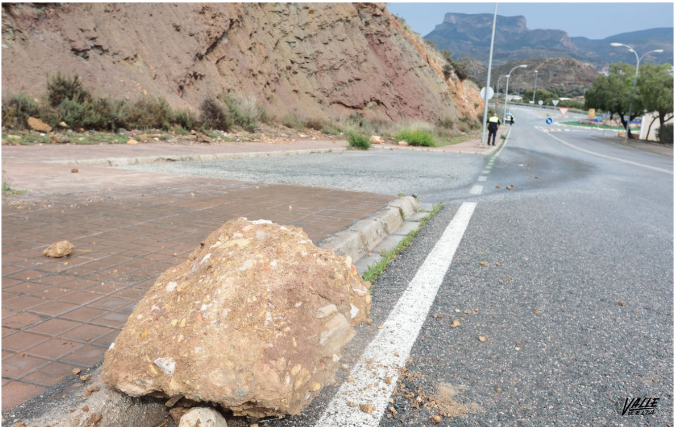
Imagen de las piedras desprendidas.
